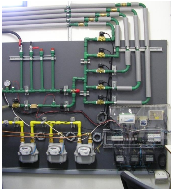
Figura 3: Fotografía del tablero de medición y control
